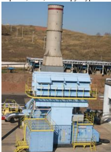
Рисунок 1 – Внешний вид газоперекачивающего агрегата
